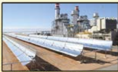
Centrale Thermo Solaire d'Ain Beni Mathar
